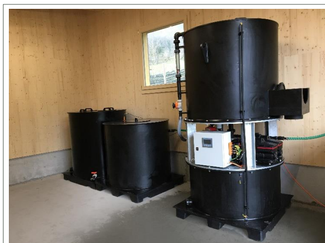
Aktivkohlefilter-Anlage mit dem Partikelfilter-Modul (Behälter links), dem nachgeschalteten Speichertank (mittig) sowie dem PSM-Modul mit der Aktivkohle (Säule rechts). Foto: S. Schäfer.
